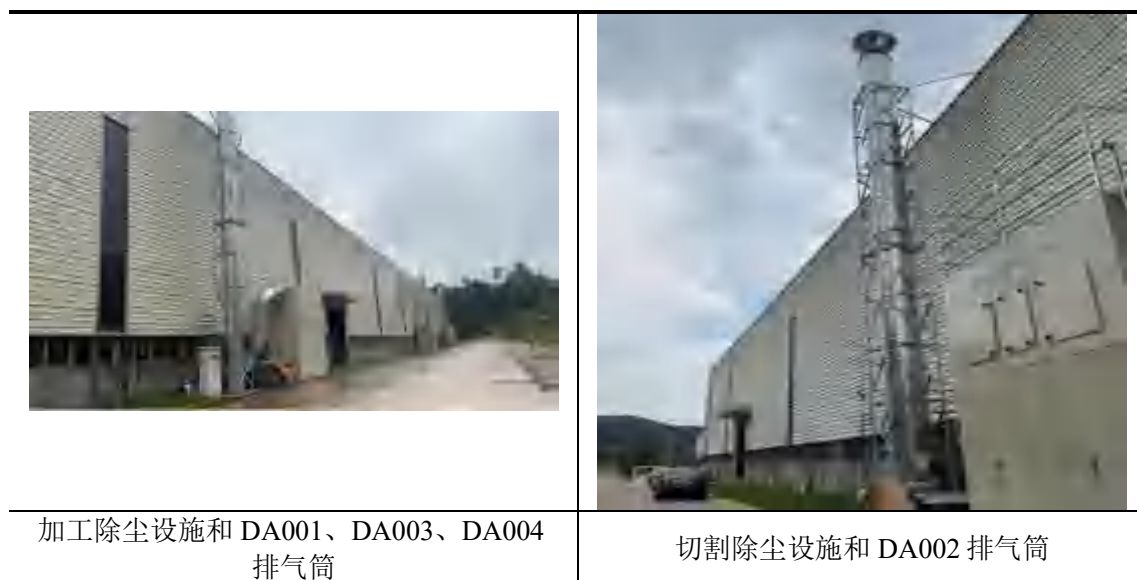
图 3-8 中机院碳材料生产项目废气治理设施现状
