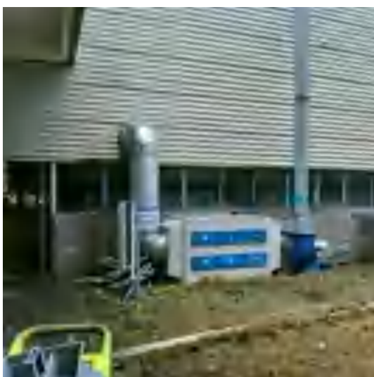
喷漆处理设施
