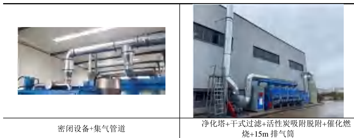
图 3-5 塑料改性新材料及装备生产项目废气治理设施现状
