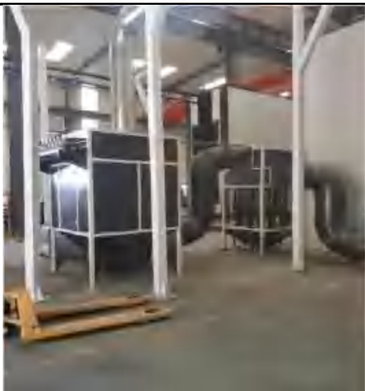
喷粉除尘装置
