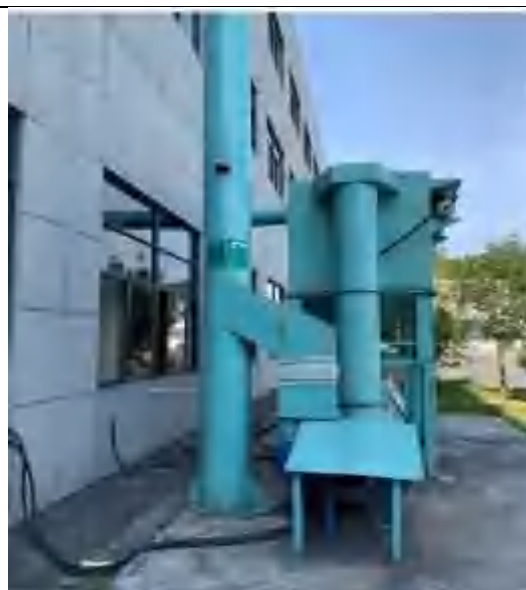
带锯床粉尘废气排放口 DA001
